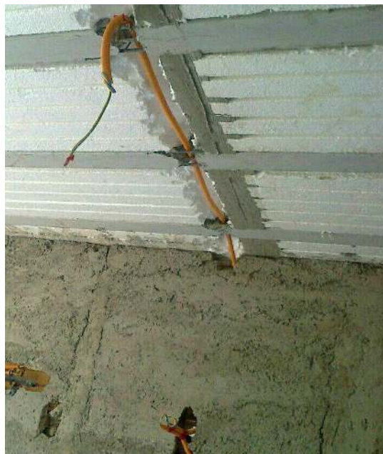
نمونه‌ای از سیم کشی توکار (از سقف و دیوار)
