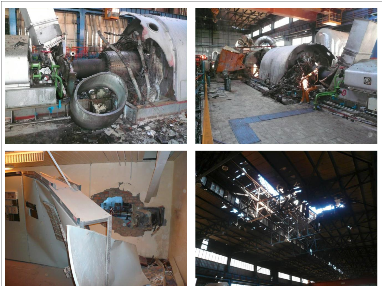
شکل ۳-۱۴-۳- واحد ۳ نیروگاه ایرانشهر که در حادثه مورخ ۸۷/۰۹/۰۴ دچار آتش‌سوزی و آسیب فراوان شده است
