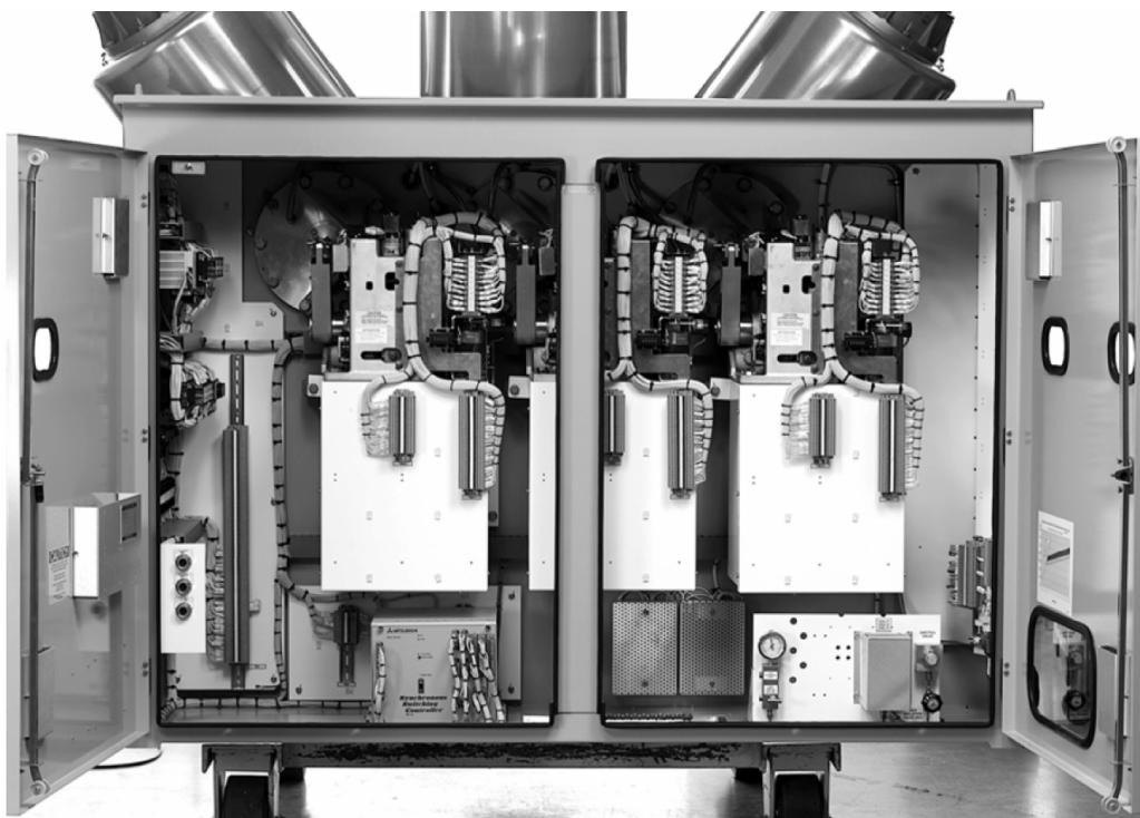
تصویر ۲۱-۱۵: کلیدزنی سنکرون در یک مدارشکن گازی
